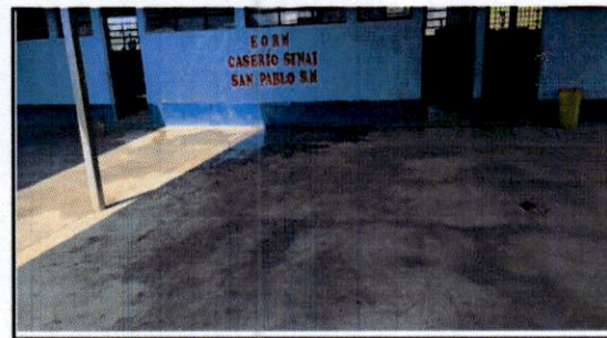
FOTO 6: Sustrucción de piso de torta de concreto
